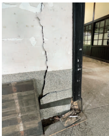
圖 3-1-6·0403花蓮地震歷史建築交通部台鐵管理局花蓮管理處建築牆面開裂
