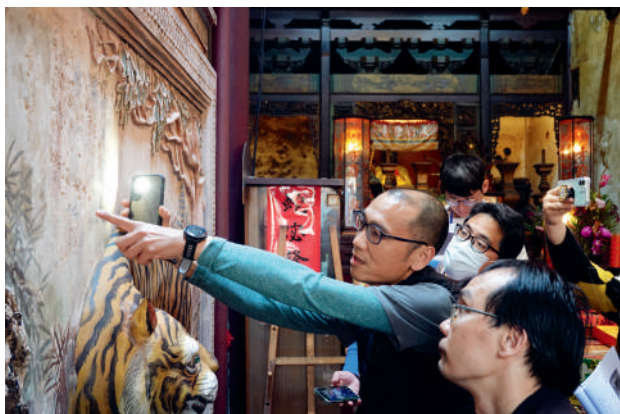
圖 5-3-13 · 臺南金華府－利用側光觀察泥塑劣化情形
