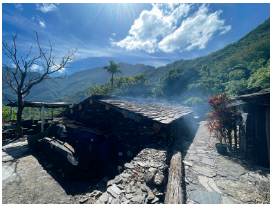
圖 2-4-7 · 屏東縣春日鄉老七佳石板屋聚落緊急搶修加固工程（戴家）（屏東縣政府提供）
