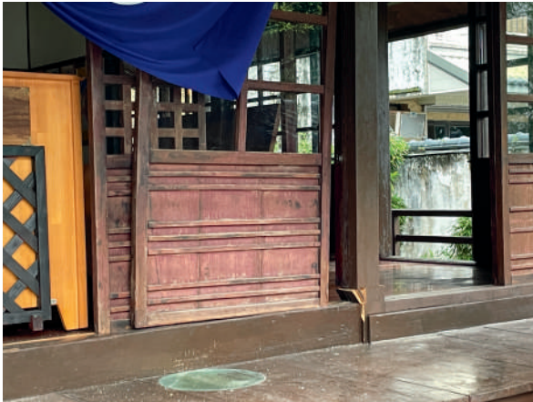
圖 3-1-7·0403花蓮地震縣定古蹟 吉安慶修院本體柱腳開裂
