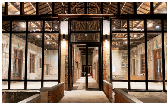
圖 2-3-35·「虎尾眷村聚落建築群（建國一村）眷舍修繕及二期景觀工程（丁棟）」一字長型庫房建築（雲林縣政府提供）
