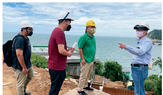
圖 2-3-29 · 「戰地轉身·轉譯再生」連江縣再造歷史現場計畫－86 據點第一期修復工程現勘
