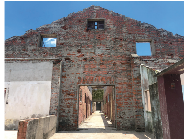
圖2-3-27 · 雲林縣「虎尾眷村文化特區 ( 建國一、二村 ) 聚落歷史現場保存再現計畫」—眷舍修繕及二期景觀工程 ( 丁棟 ) 現況
