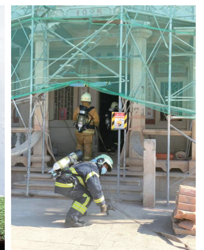
圖3-1-7 金門縣歷史建築張文帝洋樓修復工地現場防災搶救演練
