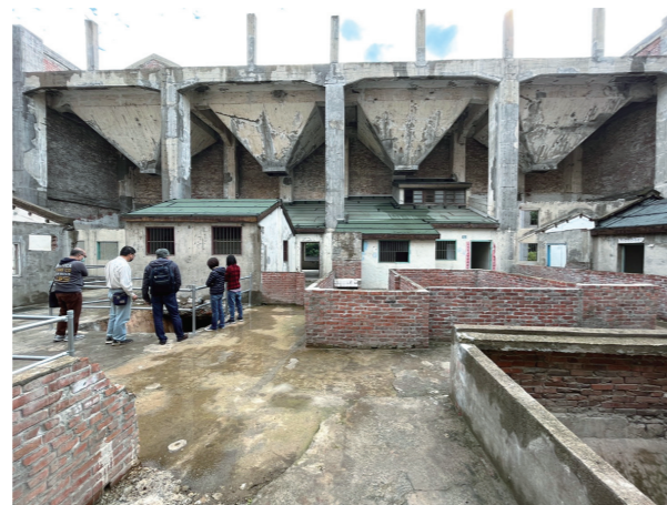
圖2-3-26 · 新竹市「歷史建築日本海軍第六燃料廠新竹支廠修復再利用第一期工程」現場
