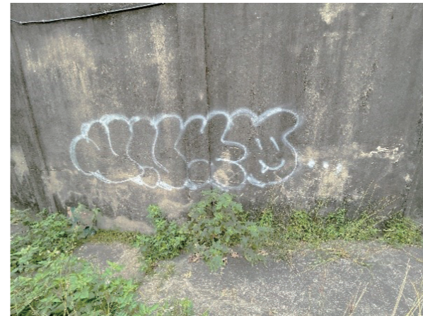
圖5-2-13 · 國定古蹟嘉義舊監獄外側圍牆塗鴉—清潔前
