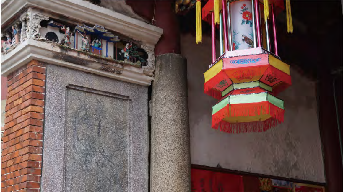
【圖3-1-1】臺南市國定古蹟祀典武廟災損情況
