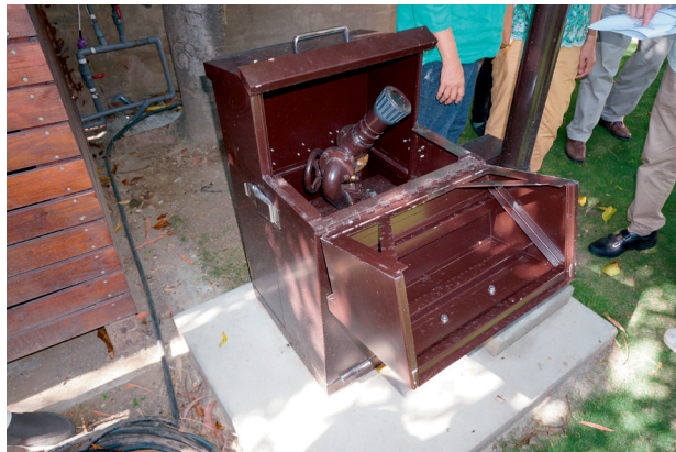
國定古蹟（赤嵌樓）設置自主性防災設備機具之自動放水槍
